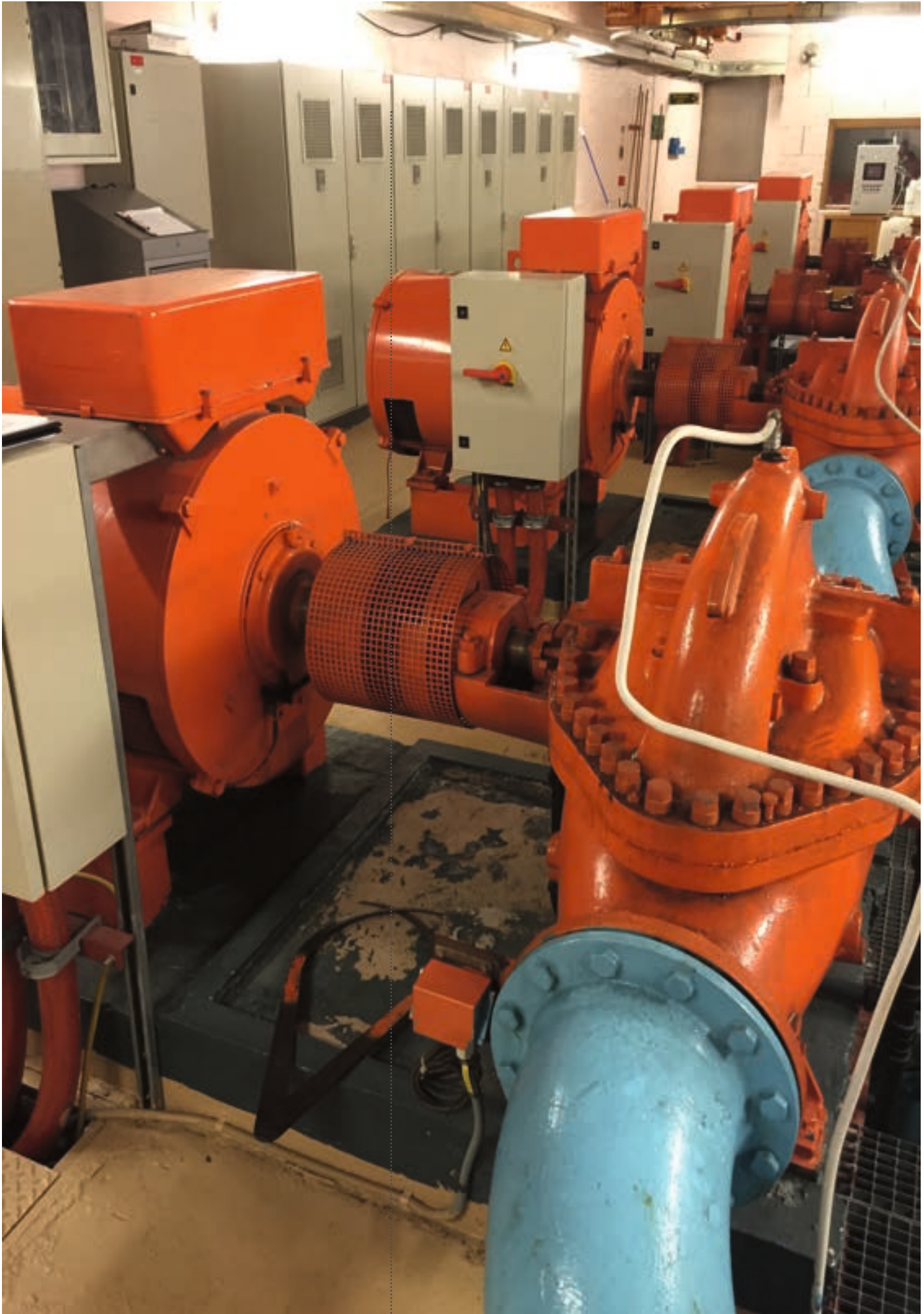
Disen pumpestasjon i Oslo for drikkevann.
