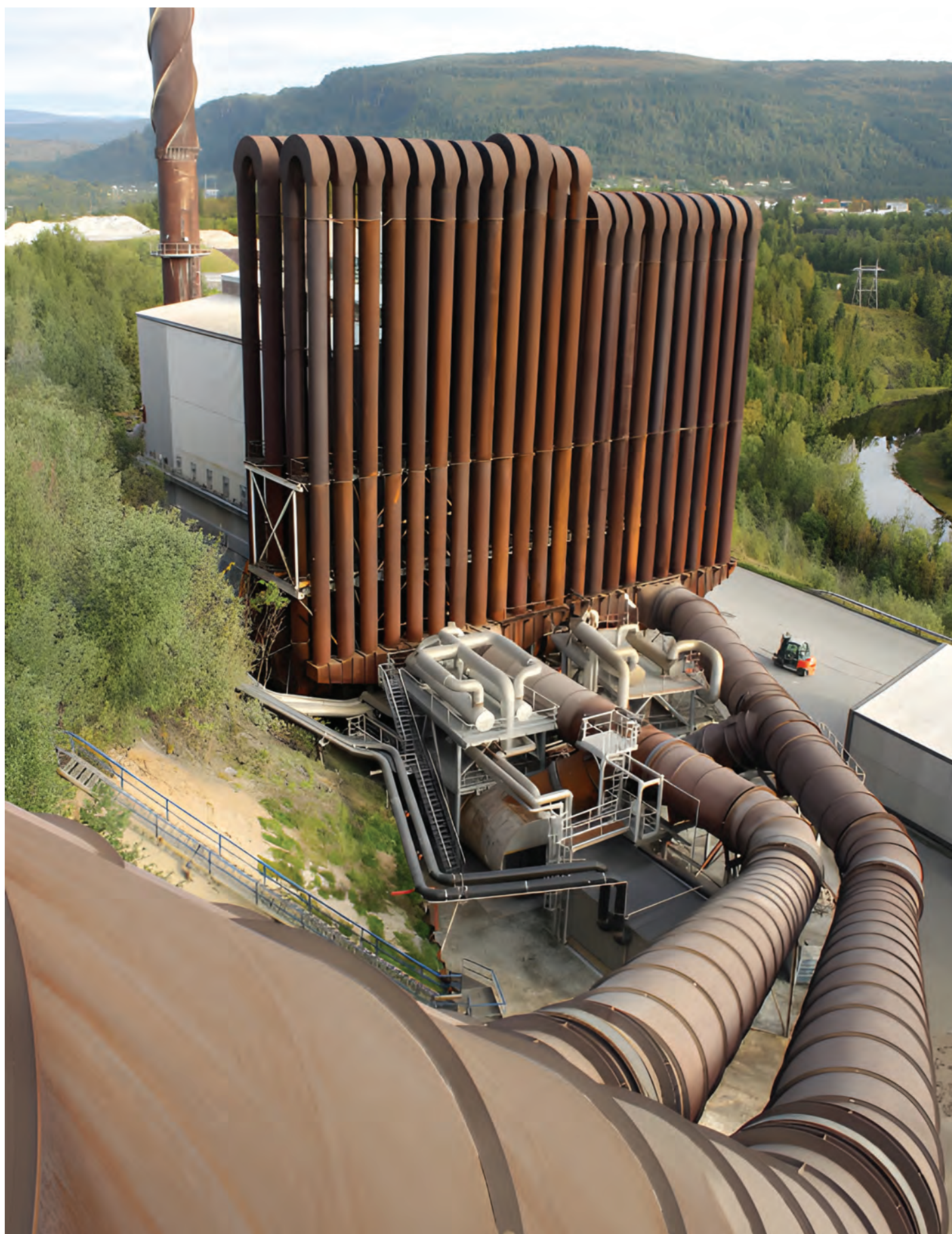
Røykgassvarmen fra smelteovnene til Elkem Rana er hovedkilden til fjernvarmen i Mo i Rana. Bildet viser begge røykrørskjelene som Mo Fjernvarme bruker for å gjenvinne energi fra røykgassen, plassert foran luftkjølerne og støvfilteret til Elkem.
