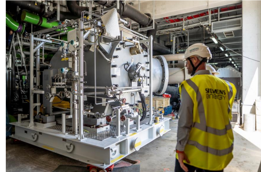
District heating system, Vattenfall Wärme Berlin, Germany
