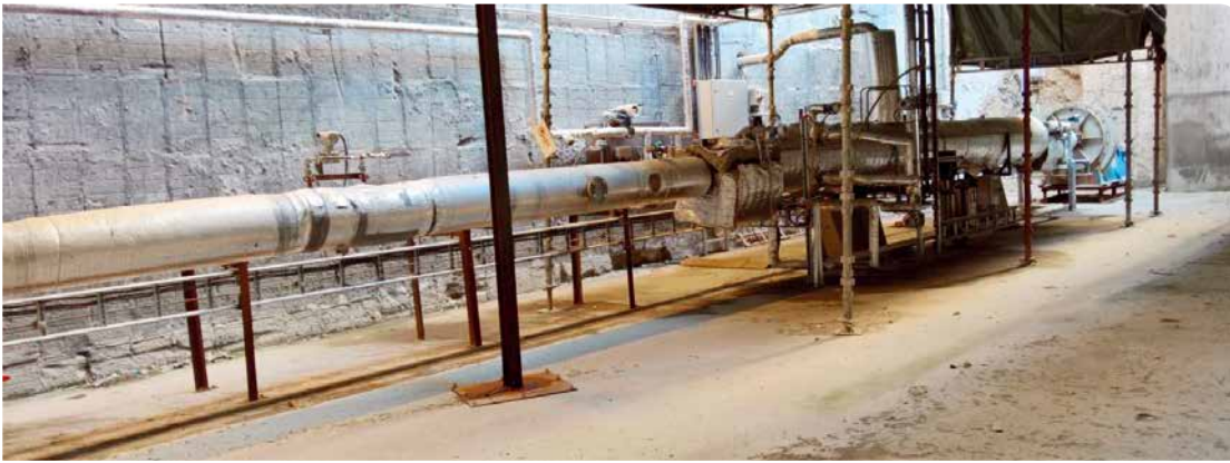
Fra 2017 gjorde Norsk Energi fysiske tester av varmeovergang og støvbelegg fra sementavgassen i en pilotkjel. Disse testene la grunnlaget for DNVs teknologikvalifisering av teknologien i 2019. (Foto: Norsk Energi)
