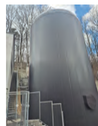
Nydalen energi har utvidet sin Energisentral med ny akkumuleringsstank på 1100 m 3 .
