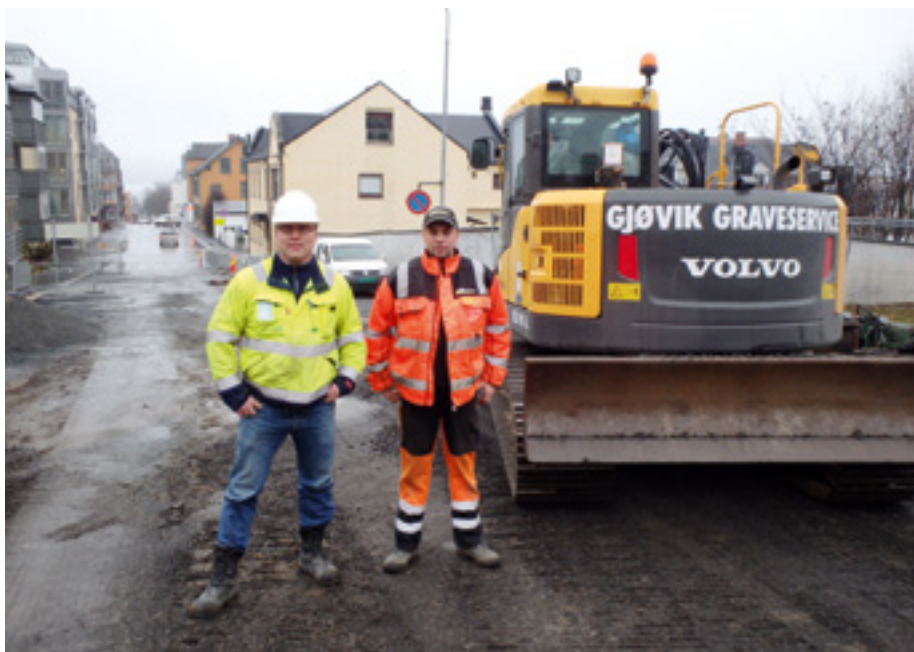
Gjenfylling av grøft i Bjørnsonsgate. Jan Erik Stensby, Norsk Energi (tv) og Atle Hagen, gravemaskinfører i GGS.
