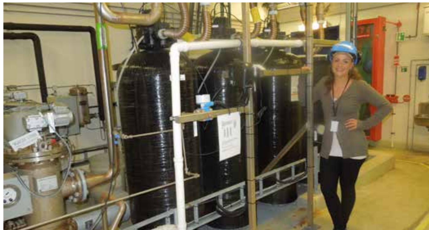
Tove Svardal er ingeniør i Arcon Industriell Vannbehandling og står her ved et avherdingsanlegg for fjernvarmenett.
