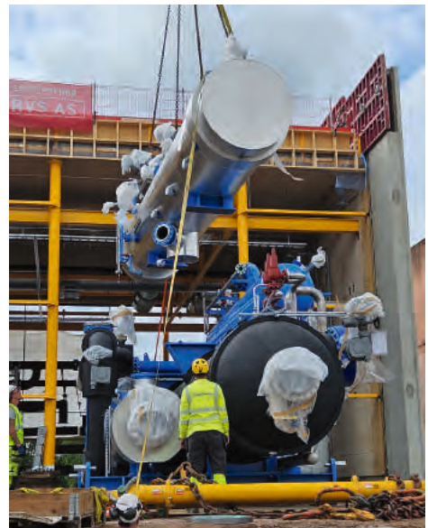
Plassering av kondensator på fordamperskid.
