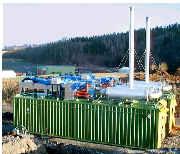
Gassmotor ved Lindum avfallsanlegg
